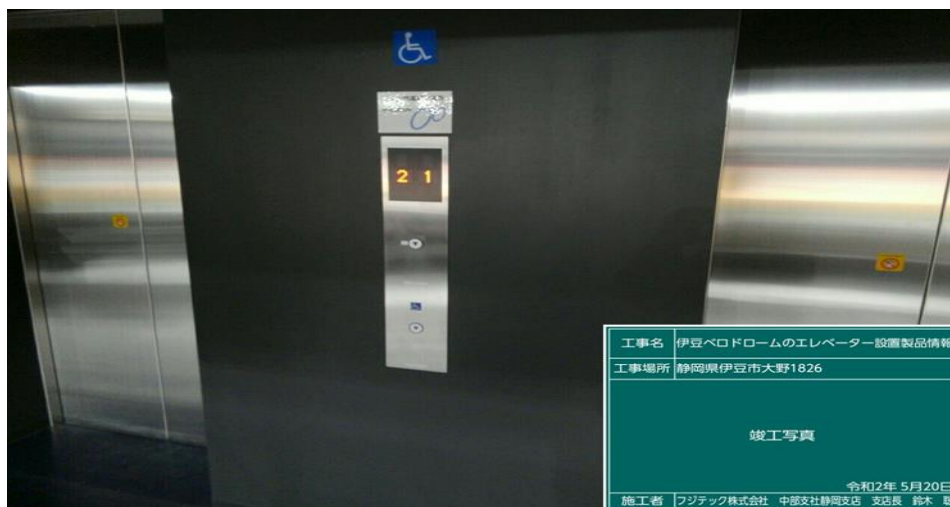
竣工 搭乗押しボタン
