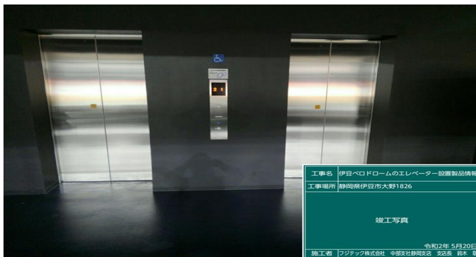
竣工 エレベーター2基
