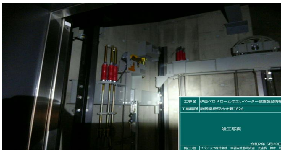
竣工 昇降路内
