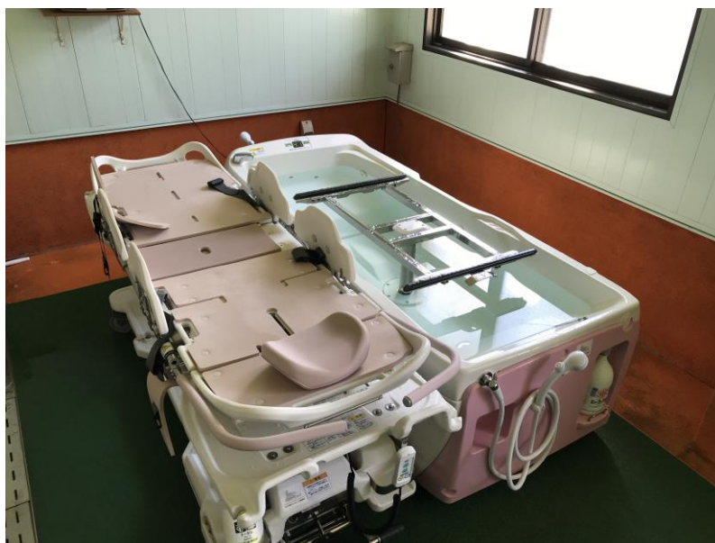
○設置された特殊浴槽
